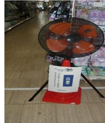
店内に十数台の換気設備を設置し、常時換気を行っております
